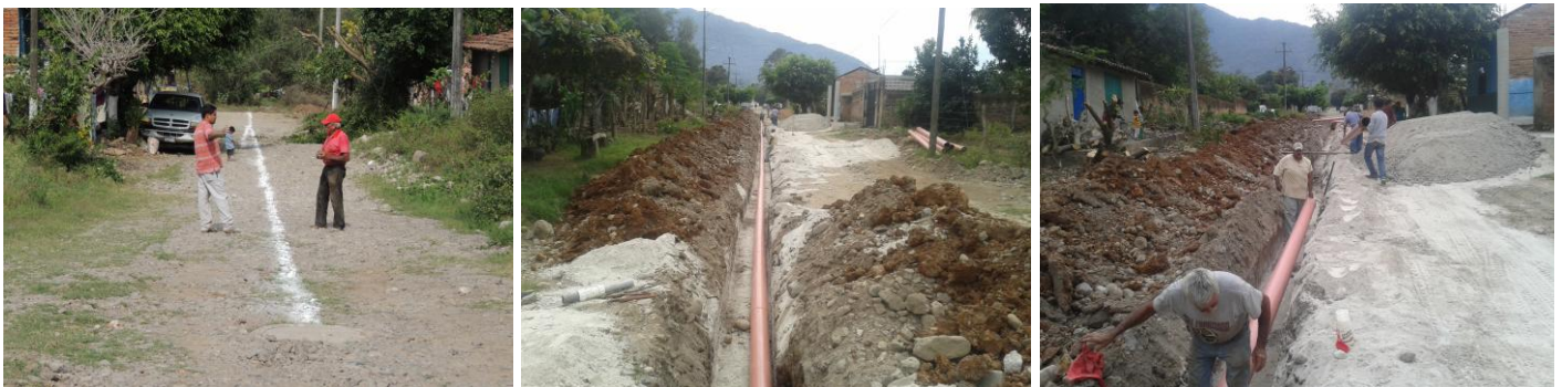
CONSTRUCCIÓN DE RED SANITARIA EN LA CALLE FRANCISCO I. MADERO EN LA LOCALIDAD DE PIEDRA PESADA, MUNICIPIO DE CASIMIRO CASTILLO
